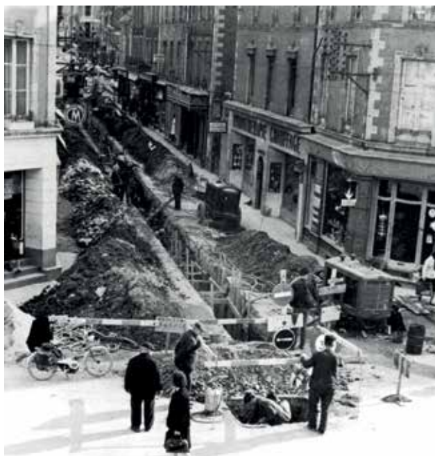
Les travaux en cours dans la rue Aristide Briand où fut posée la première canalisation d'assainissement en 1961.
